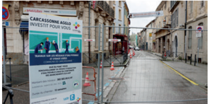
Investissement dans la rue du pont-vieux avec des travaux sur les réseaux d'eau et d'assainissement.
